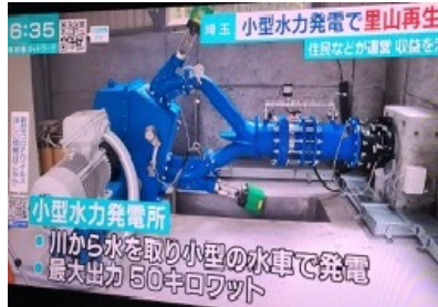
TVで紹介された寺沢川発電所
