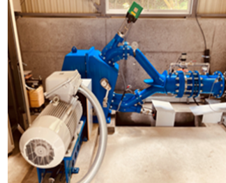
発電機（手前）とペルトン水車（奥）
