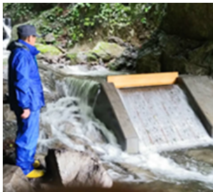
取水口（コアンダー）
